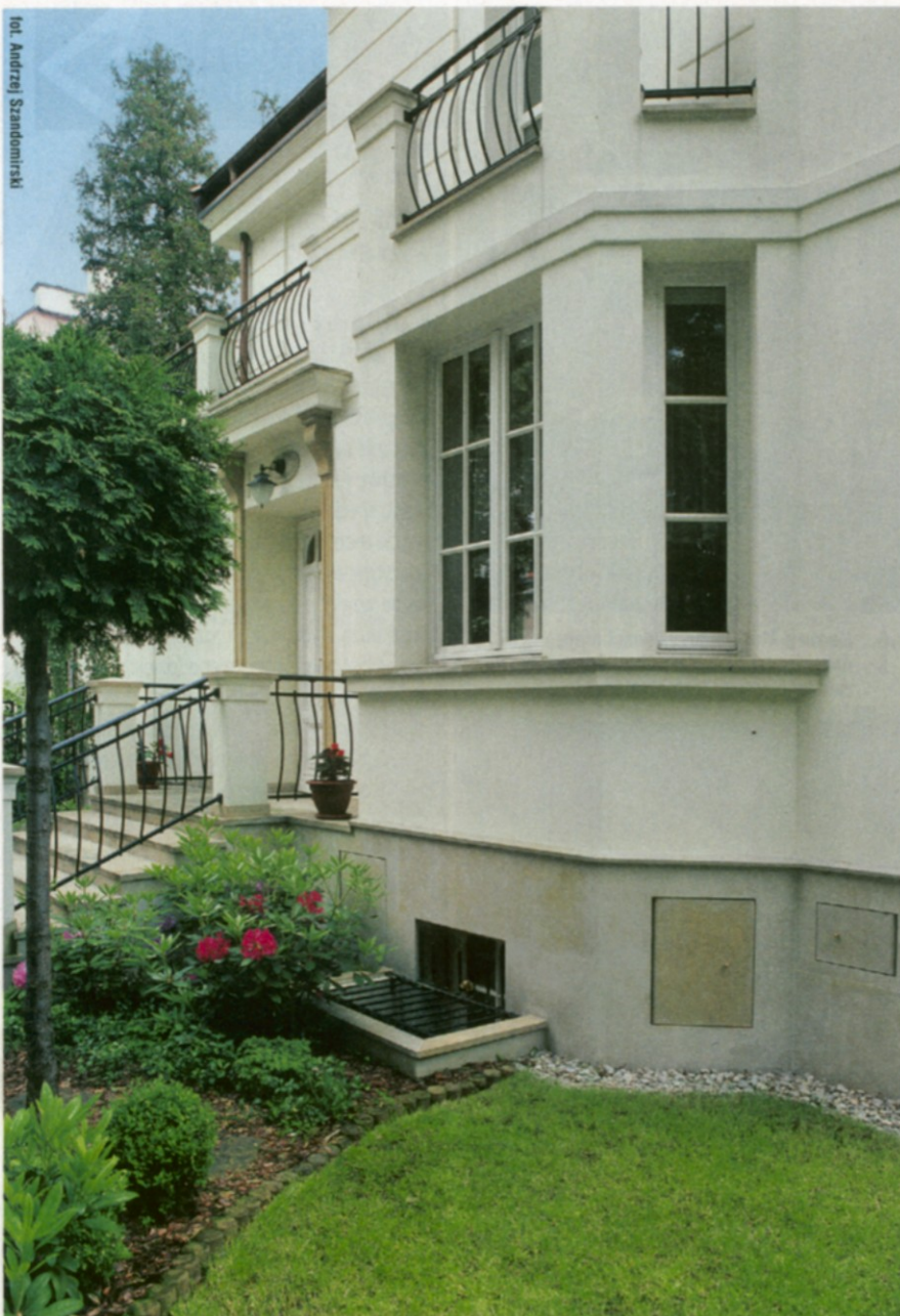
↑ Pionowa i pozioma izolacja przeciwwodna, prawidłowo ukształtowana elewacja oraz kamienna opaska wokół cokołu to czynniki, dzięki którym w piwnicy jest sucho
