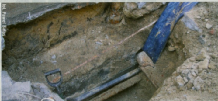
↑ W próbnym wykopie odkryto element, który okazał się ściśle przylegającą do ściany obudową instalacji. Brak dokumentacji odnotowującej tego rodzaju przeszkody sprawił, że trzeba było zrezygnować z metody bezwykopowej
