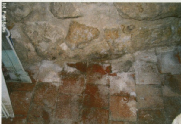
↑ W zawilgoconej piwnicy przemieszczająca się w ścianach woda osadza na nich sole. Gdy woda odparuje, na powierzchni ścian pozostają nieestetyczne wykwity
