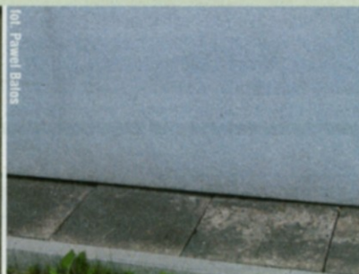
↑ Opaska dookoła cokołu musi być ukształtowana ze spadkiem na zewnątrz. W przeciwnym razie nie tylko nie będzie chroniła ścian piwnicy, ale spowoduje, że będzie na nią oddziaływać jeszcze więcej wody opadowej
